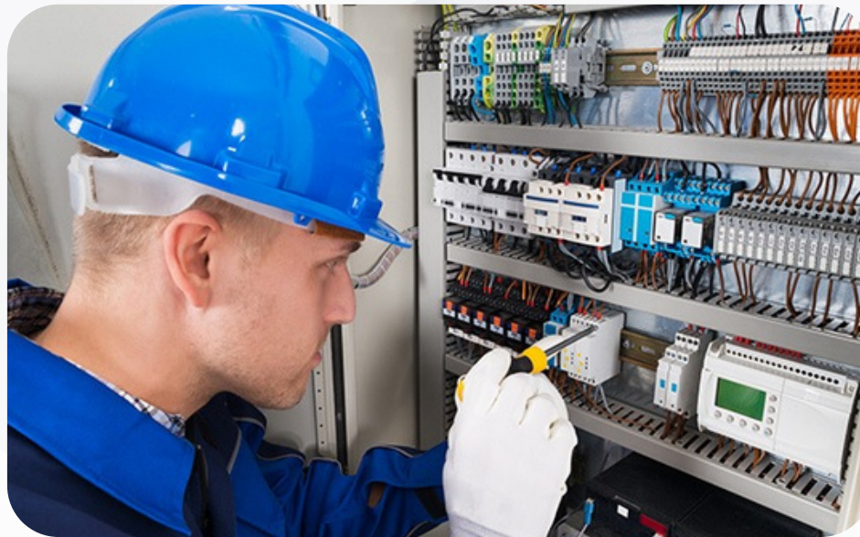
PRÉPARATION À L'HABILITATION ÉLECTRIQUE
