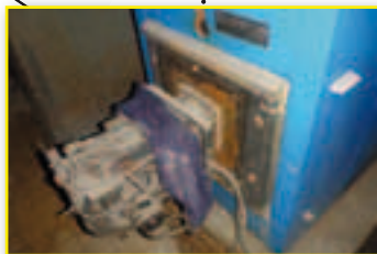
Joint de brûleur chaudière
