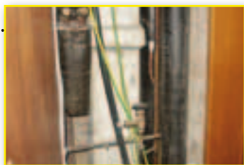
Tuyau de ventilation
